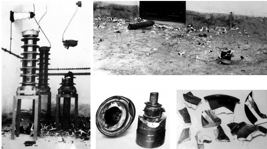
Bild 4: Zersprengte Überspannungsableiter /Dissertation Koettnitz [18]/
