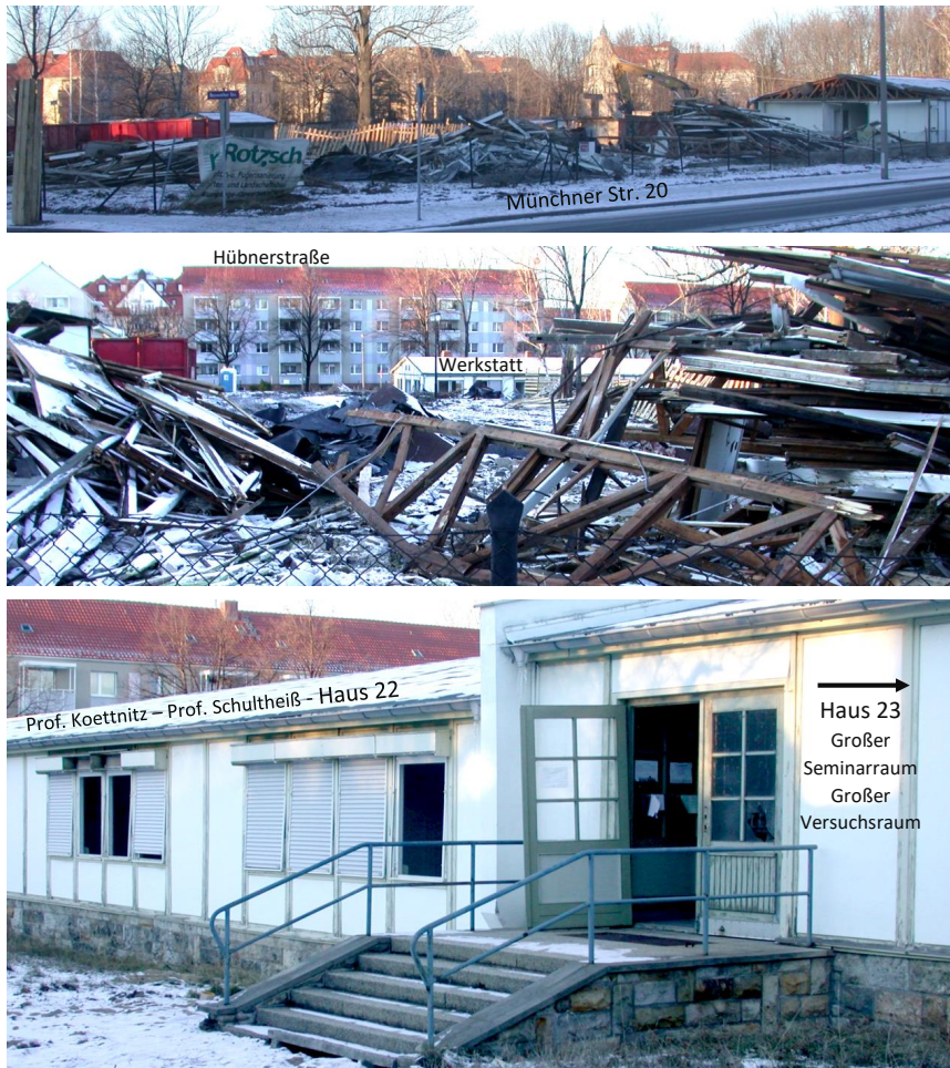
Bild 14: Abriss der Montagehäuser vom ehemaligen Institut für Elektrische Energieanlagen IEA zwischen Münchener Straße 20 und Hübnerstraße 25 (s. Seite 30) /Foto: H. Bauer 23.12.2003/
